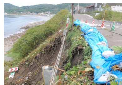
塩谷市道 2012年 大雨による土砂崩れ被害
