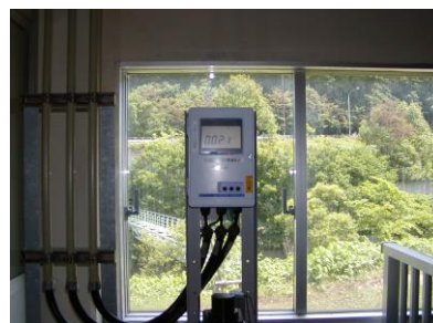
ろ過水濁度の常時監視装置
