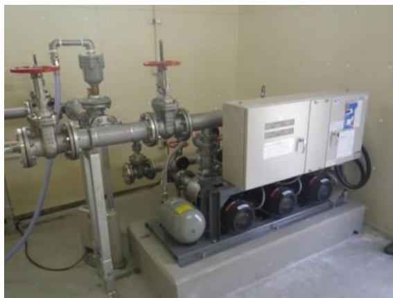
〈インバータ制御による配水ポンプ〉
