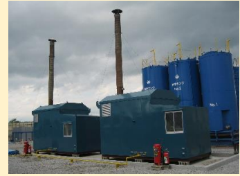
ハウス内部にはボイラー、給水タンク、ドレン回収器、軟水器、薬注装置などを設置しておりトラックで移動可能
