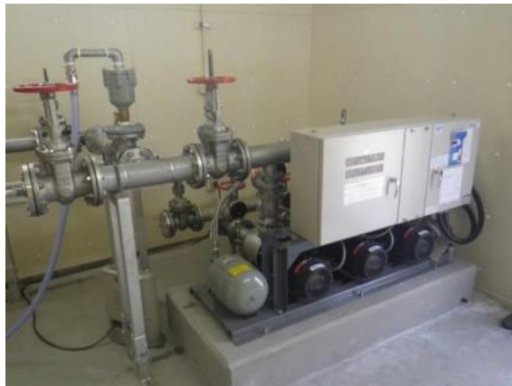
〈インバータ制御による配水ポンプ〉
