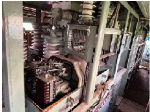
計器用変圧器
