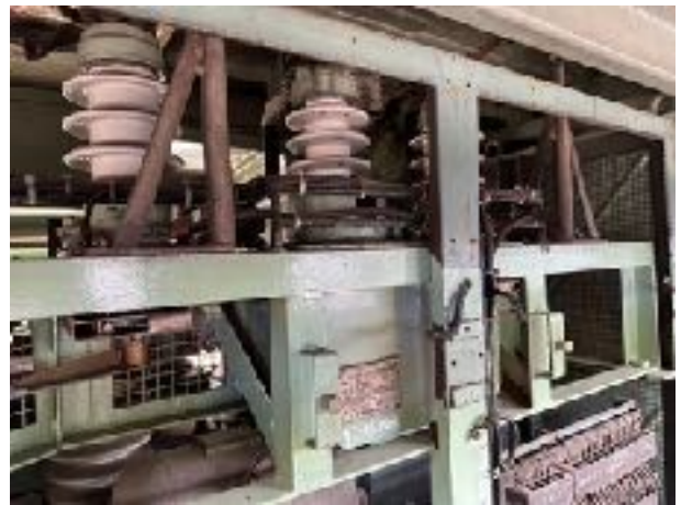
計器用変圧器
