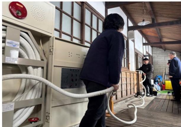
写真② 防災訓練での屋内消火栓使用状況
