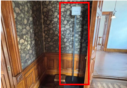
写真① Wi-Fi機器設置状況
