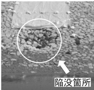
満水位下約4mの地点に見つかった円すい状の陥没箇所。
